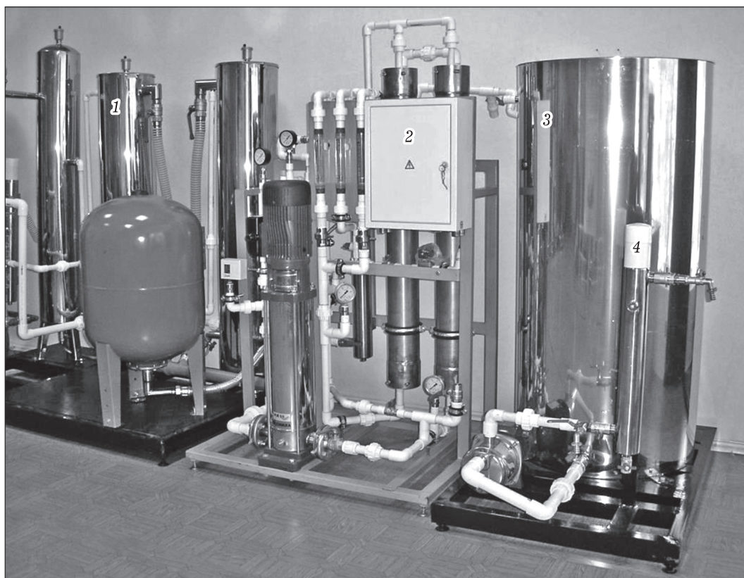
Рис. 2. Автономная установка производительностью 0.5 м 3 /ч для коллективного пользования: 1 – узел предварительной очистки воды; 2 – узел обратного осмоса; 3 – бак для очищенной питьевой воды; 4 – ультрафиолетовая лампа.
